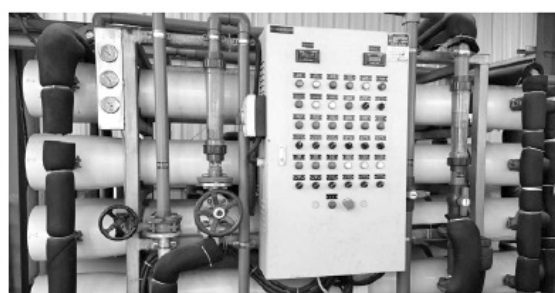
RO膜処理設備外観
